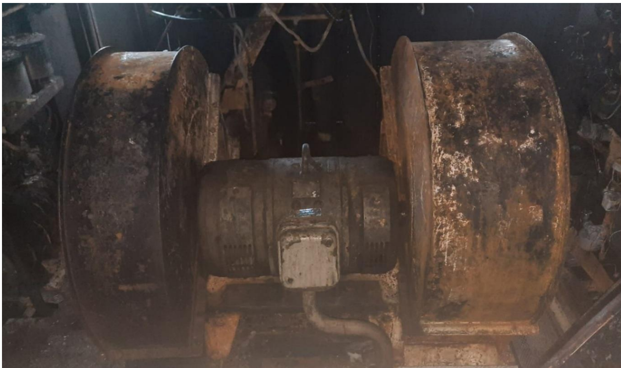
Foto nr.4. Grup ventilație boghiu 2 afectat termic
