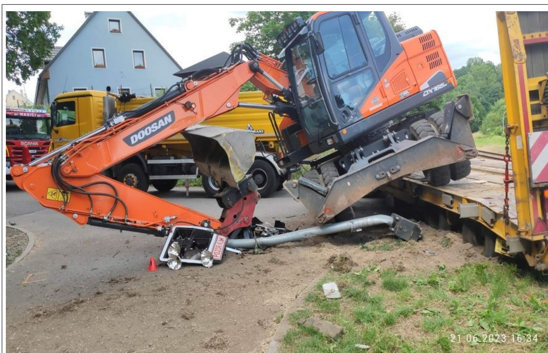
Obr. č. 5: Pohled na poškozený výstražník a NA s přívěsem a bagrem po MU
