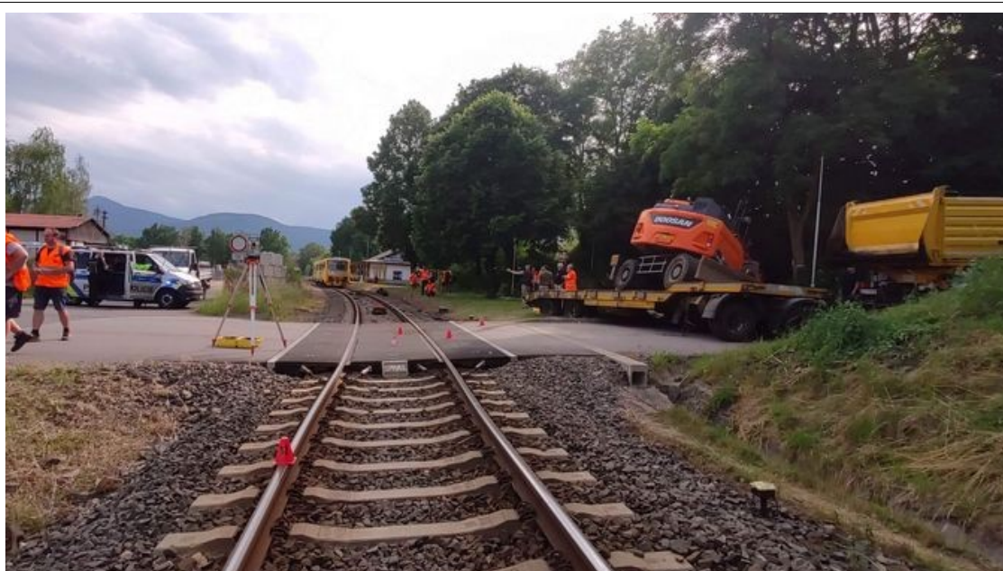
Obr. č. 3: Pohled na ŽP ve směru jízdy vlaku Os 6385, poloha NA po MU
