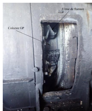
Foto nr.2 – Generatorul principal
