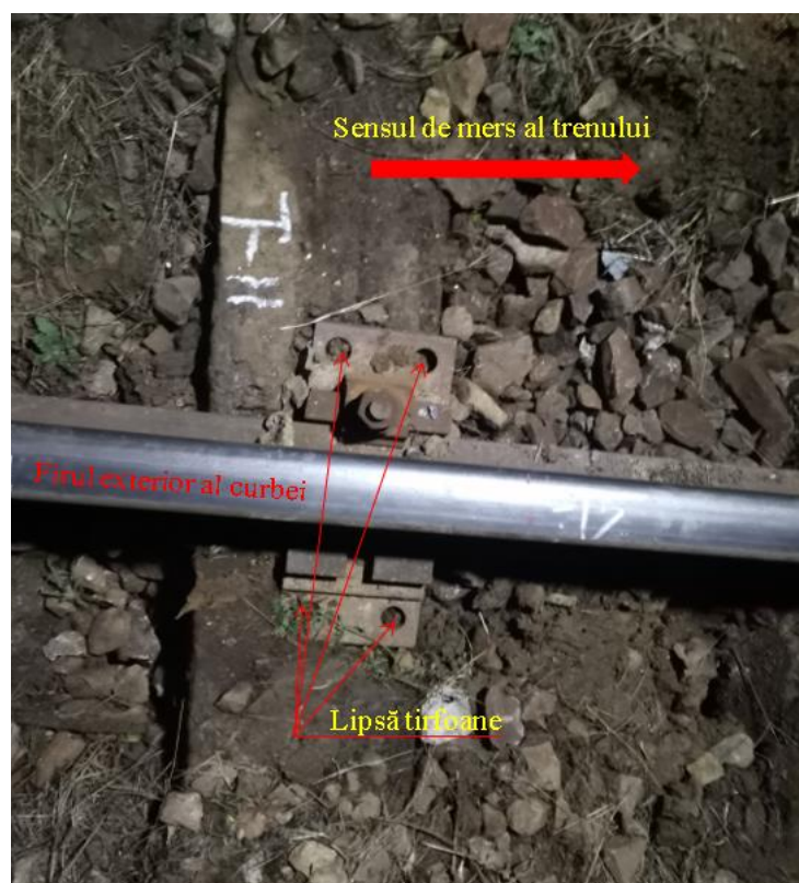
Foto. nr.3 – Starea tehnică a traversei T-11
