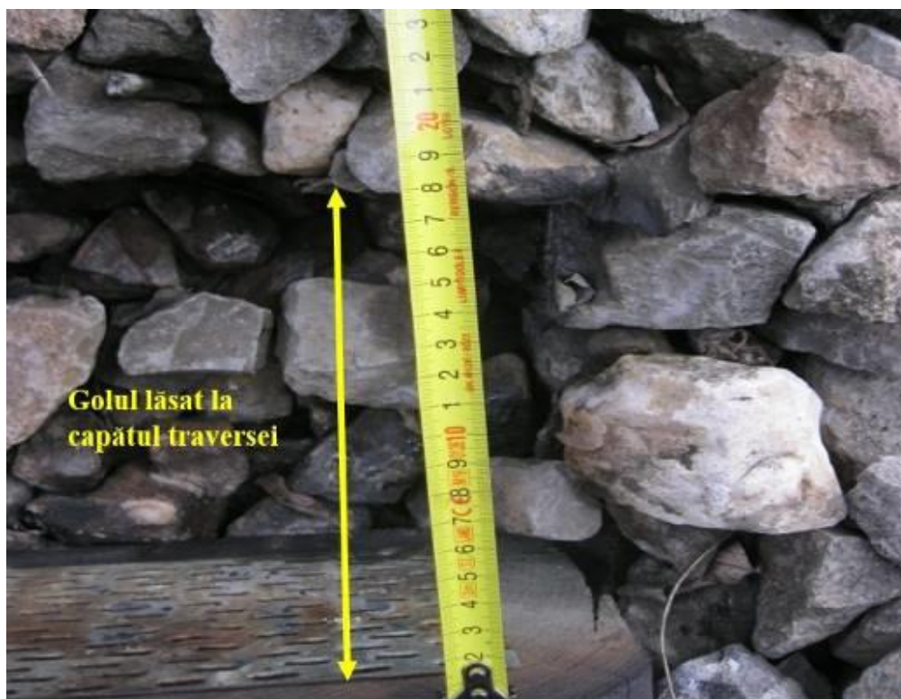
Foto nr.5 – Traversă deplasată
